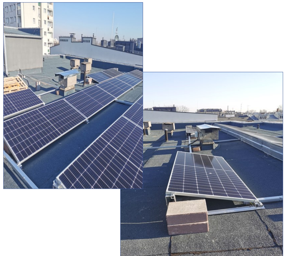
Instalacje fotowoltaiczne na budynkach Łomżyńska 22/24 i Łomżyńska 15/25
