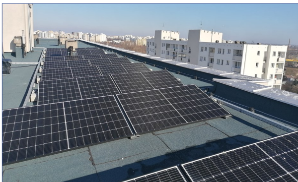
Fotowoltaika na dachu budynku w Osiedlu Kijowska
